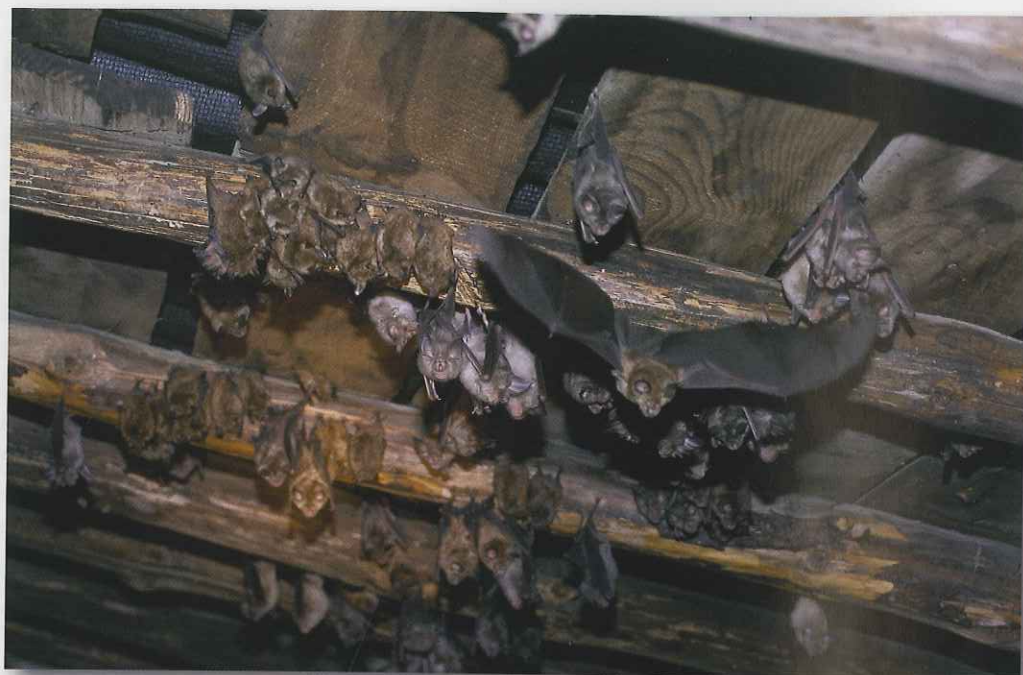
Desván con vigería tradicional de madera, ocupado por una colonia de murciélagos de herradura y ratoneros pardos.
