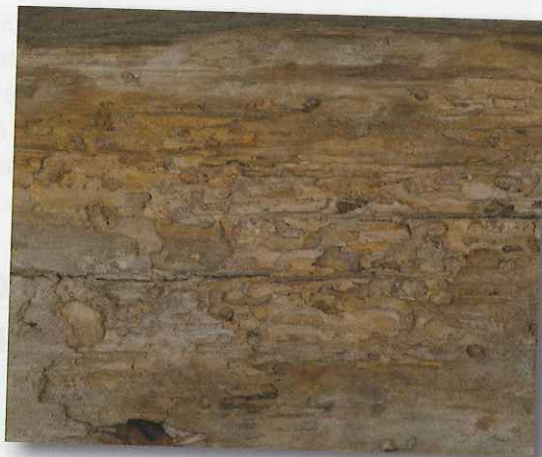
Viga atacada por insectos xilófagos. En los tratamientos deben tomarse las precauciones oportunas para no perjudicar a los murciélagos presentes.
