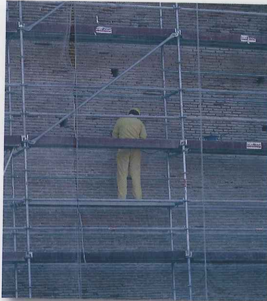
Antes de sellar las juntas y fisuras de un muro, hay que asegurarse de que no hay murciélagos en su interior.
